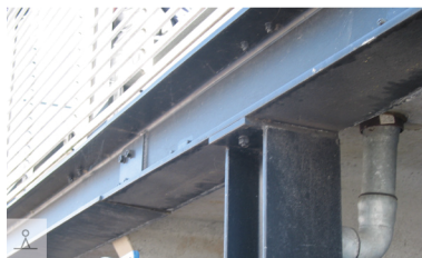
eenvoudige verbinding met opgelaste plaat, tijdens de montage is de ligger vastgebout (parkeergarage nabij openbare bibliotheek Delft)
