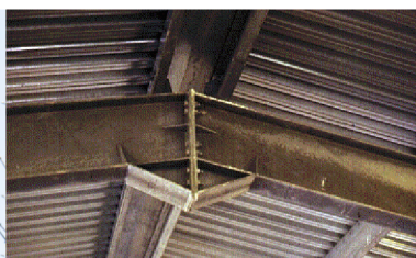
Nokverbinding van een portaal. De verstijving verhoogt de mo- ment weerstand en dus de stijf- heid
