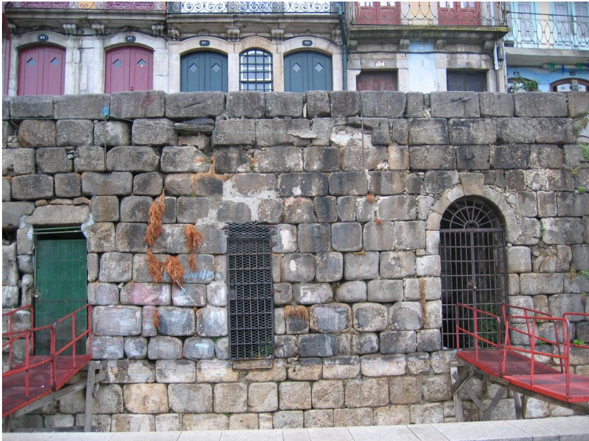
Een uit natuursteen blokken opgebouwde oude muur in de haven van Porto. Let op de goede en de slechte latei boven de opening en het hoogste rivierpeil dat zich afgetekend heeft op de muur.
