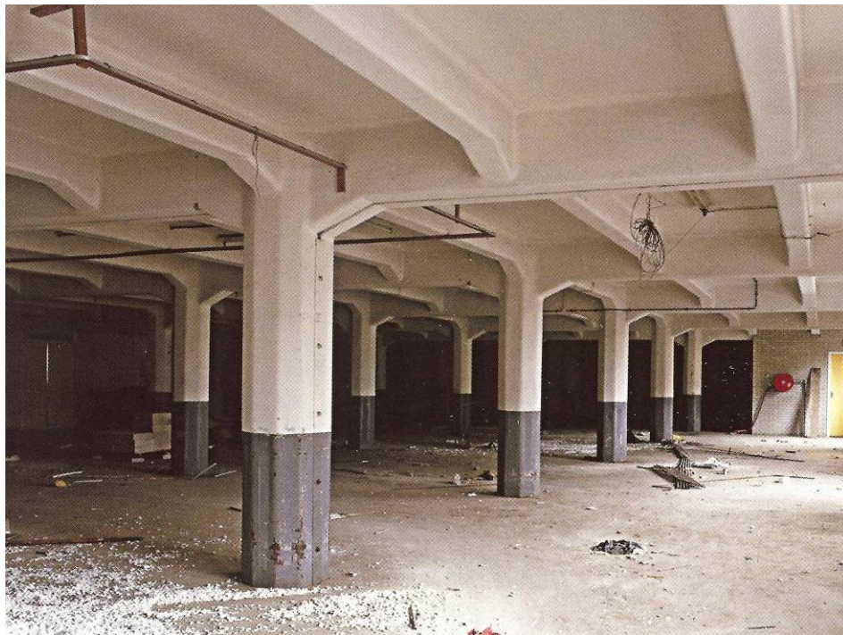
Veem Koningin Emma, Amsterdam, 1914; een klassiek balkenpatroon met dunne vloerplaten ertussen. Let ook op de leuke verzwaring van de balk vlak bij de kolom, de zogenoemde vouten; hierdoor ontstaat een sterkere inklemmingsmogelijkheid!
