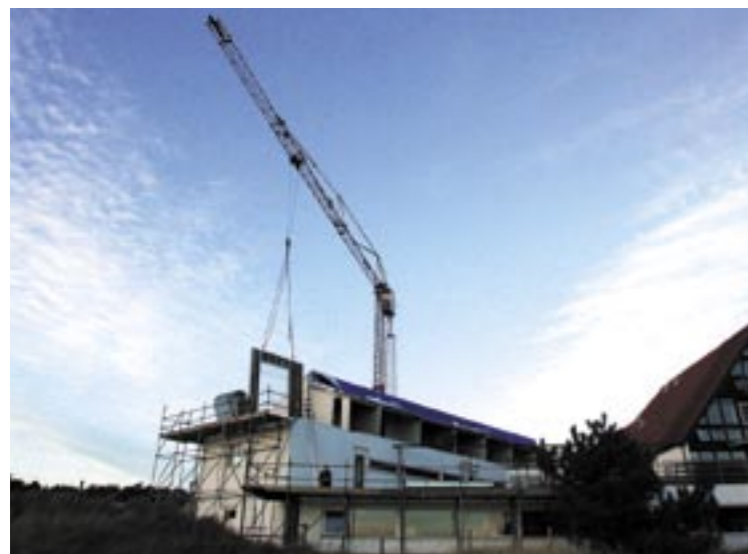
8. Optop jongerenhostel Stayokay (Terschelling, 2001). Vanwege het lage toelaatbare gewicht kon deze uitbreiding uitsluitend met staalframebouw.
