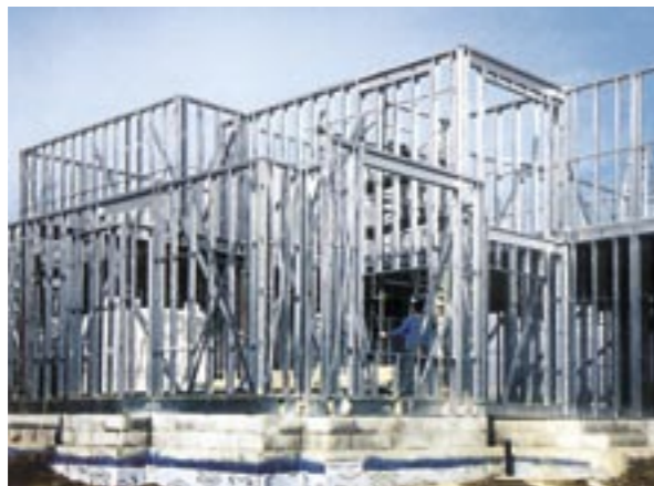
42. Assemblage van een staalframebouw woning op de bouwplaats (Armor Steel Framing Systems, Canada).
